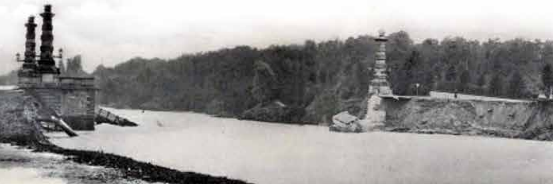
Die eingestürzte Prinzregentenbrücke
